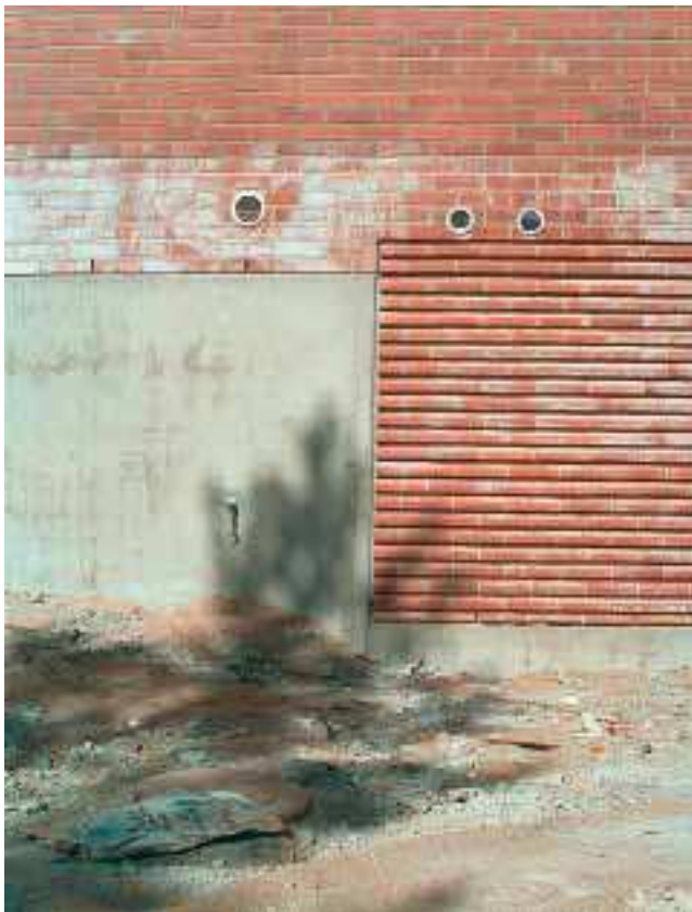
Uusiin tiiliseiniin saattaa keväisin rakenteiden kuivuttua ilmestyä vaaleita vesiliukoisia suoloja. Yleensä sade pesee nämä pois.
